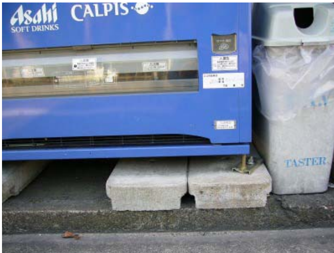
図42 避難経路の問題をチェック（倒壊の恐れのある箇所）
