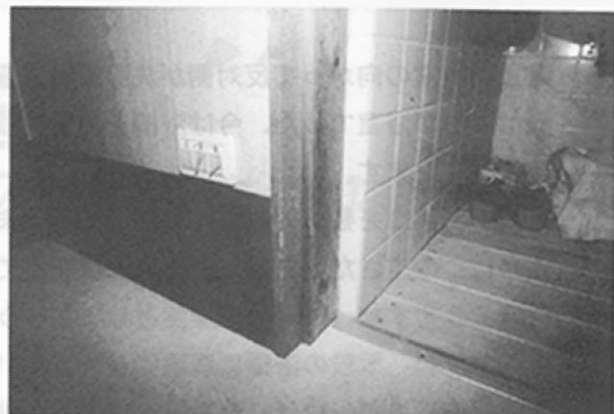
例：トイレ兼脱衣室のスイッチ
